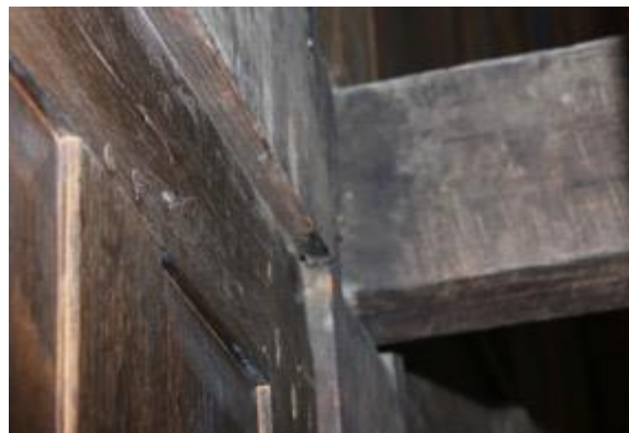
Draagbalk ter hoogte van eventueel voormalig Van Hagen Bovenwerk (Steungat heeft overbreedte voor de thans niet dragende balk)
